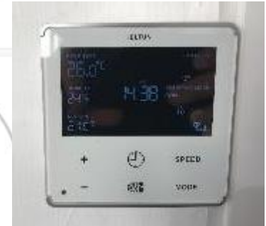
O unitate de comandă Zigbee, care include un senzor de lumina, temperatură și umiditate – utilizat în Laboratorul de inginerie a Iluminatului I108 de la Facultatea de Inginerie a Instalațiilor- UTCN
