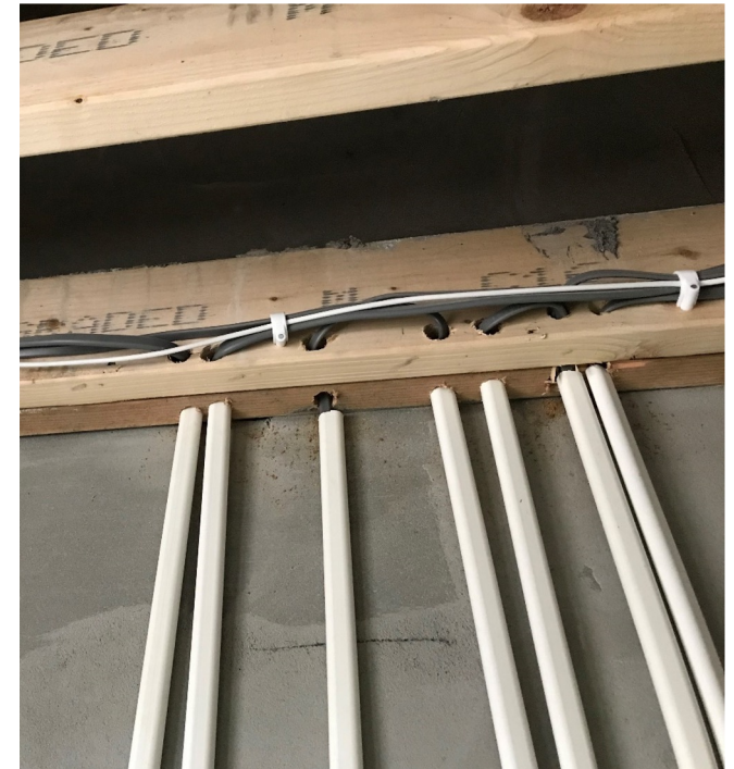
Cabluri multiple care trec prin lemn fără etanșare specializată
